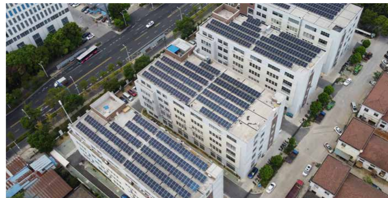
木渎光伏屋顶项目 江苏
