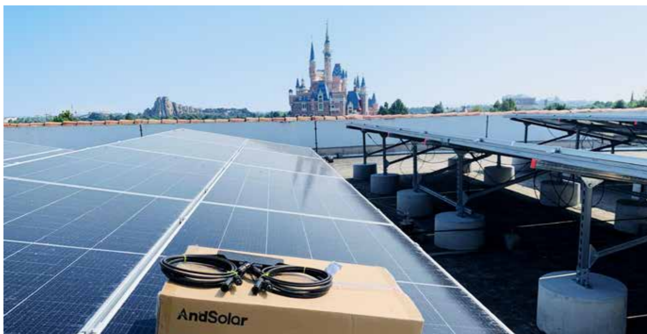
某国际乐园屋顶光伏项目 上海
